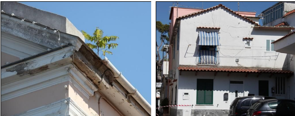
Figura 3.6-4. Marina di Casamicciola: distacco del cornicione dalla Chiesa di S. Maria della Pietà e lesioni leggere in un edificio in muratura.
