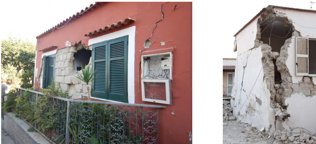
Figura 3.6-2. Casamicciola "Zona Rossa": espulsione di muratura e rottura dell'angolata muraria in edifici di classe B.
