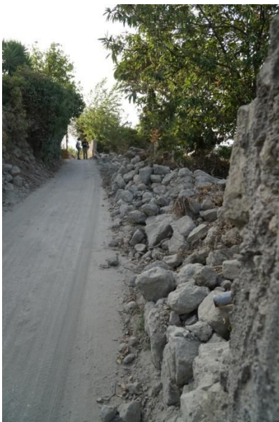
Foto 8. Crollo di un muretto a secco.
