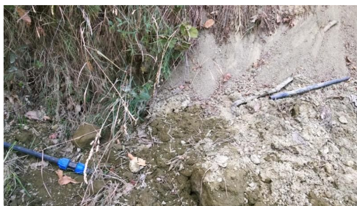
Foto 5. Particolare del danno al tubo di irrigazione.
