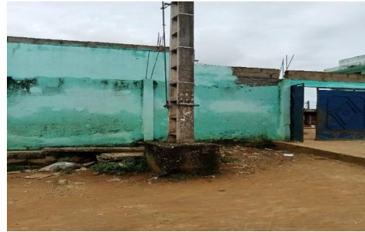
Photo n°7 : Un poteau électrique dégradé par l'érosion dans le secteur de Ciel
