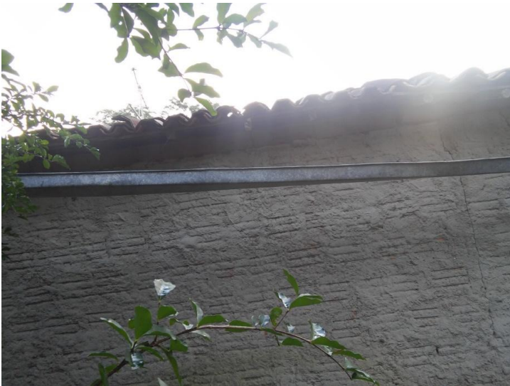
Figura 2: Calha de aço galvanizado para captar água da chuva para armazenamento
