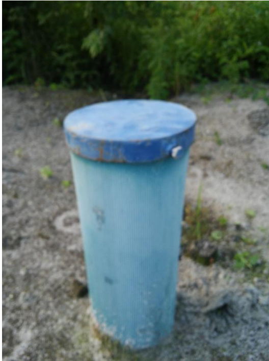
Figura 3: Poço artesiano para aproveitamento da água subterrânea
