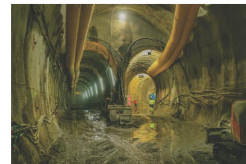
Camara de alargamento
