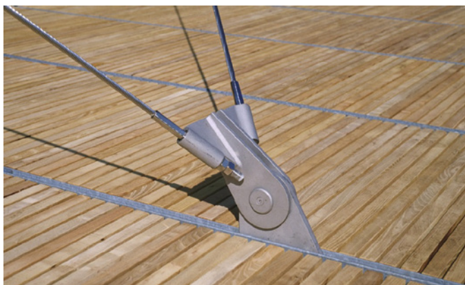
Puchheim, Kulturzentrum, Verankerung der Spannseile (Foto: Bernhard Friese für Lanz Architekten)
