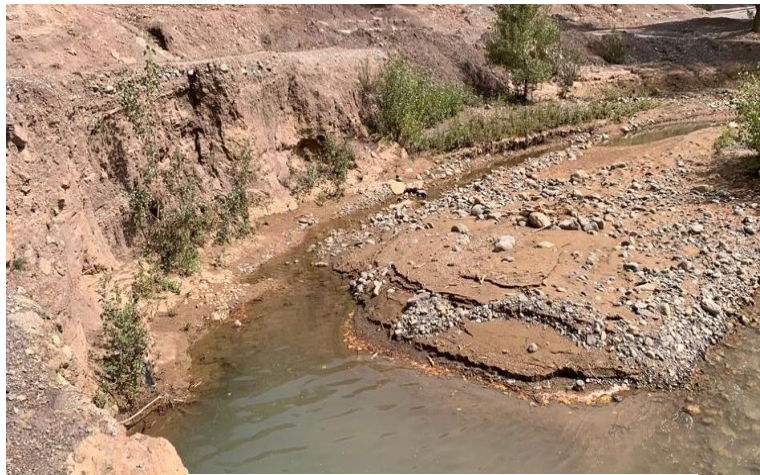
Photos N° 4: Exemple d'une berge dégradée
