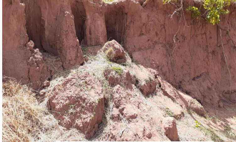
Photos N° 2: Exemple d'une berge affaissée
