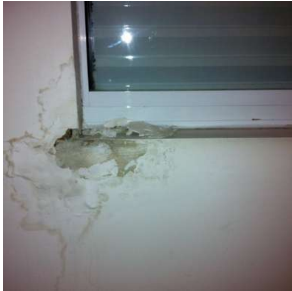
Figura 7 – Manchamento em torno da esquadria, causado por infiltração por intempéries
