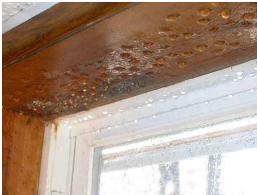
Figura 3 – Umidade por condensação Fonte: Ibraclube, 2016
