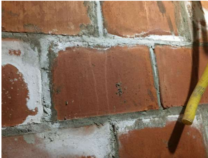
Figura 9 – Eflorescência em bloco cerâmico
