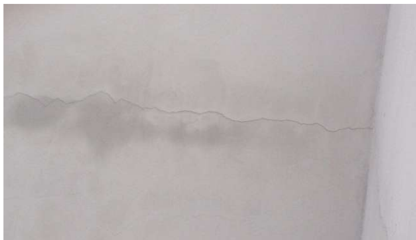
Figura 8 – Manchamento na parede de alvenaria sem geometria nem localização definida, devido à percolação de água pela abertura da trinca existente
