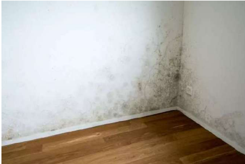
Figura 5 – Manchamento de parede devido à umidade ascendente por capilaridade
