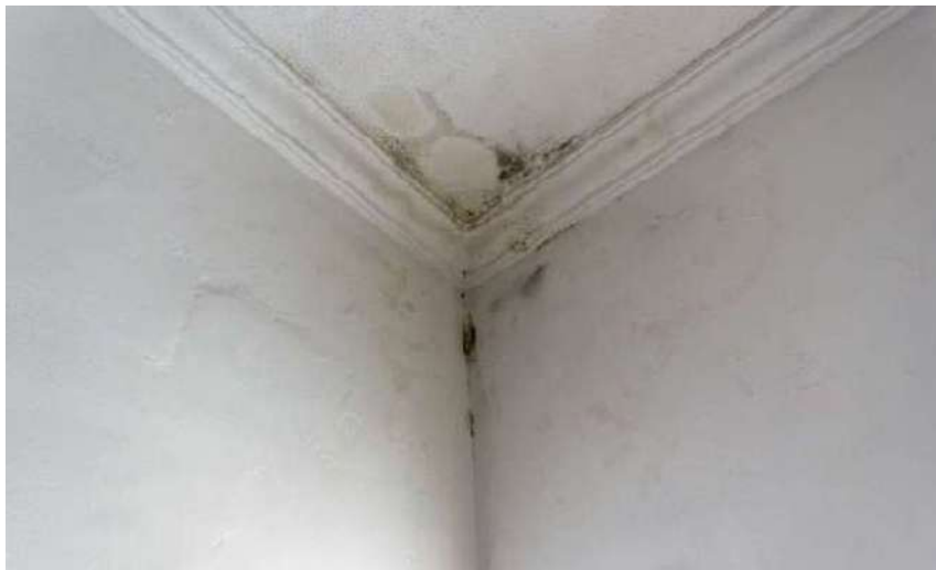
Figura 6 – Manchamento no alto da parede e no teto devido à infiltração por intempéries
