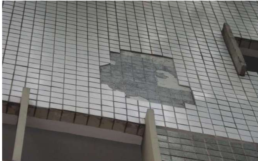
Figura 12 – Deslocamento de revestimentos cerâmicos
