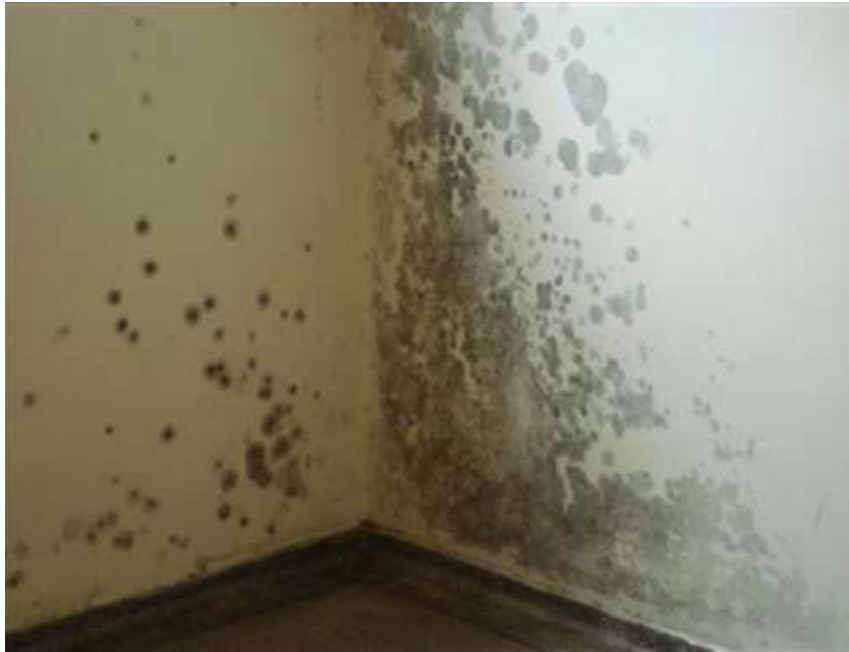
Figura 11 – Proliferação de mofo em parede de alvenaria
