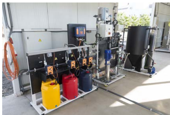
Figura 3: Foto de la instalación NF de la Unidad de Tratamientos Solares de Agua en la PSA
