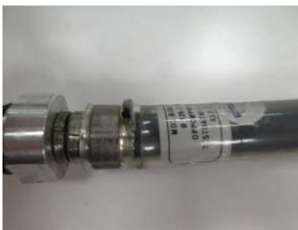
Blaas C2; beschadiging bij de lans aansluiting (smeltschade)
