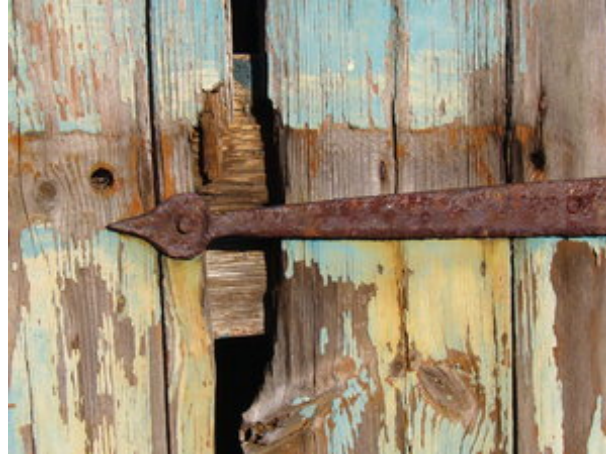
Şekil 2 Ağaç malzeme ile bağlantı halinde olan korozyona uğramış metalin görüntüsü
