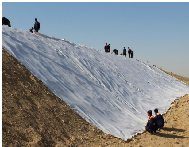
Рис. 1. Процесс укладки гетекстиля на откосы насыпи земляного полотна (перегон Кийикли – Хизирбобо 4199 км ПК 1)
