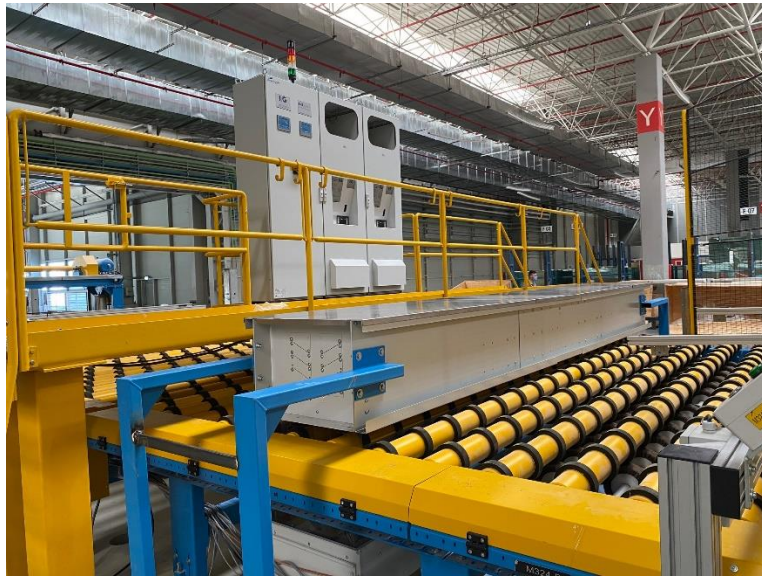
Abbildung 2 IfG Pudersystem mittig auf einer Bühne, Vordergrund Düsenrohr in Einhausung integriert
