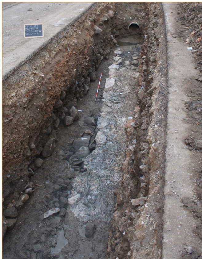
fig. 4. Este, via Settabile, vista di un tratto stradale della fase più antica con il cordolo e i riempimenti di sottofondo (Archivio SABAP-Ve-Met).
