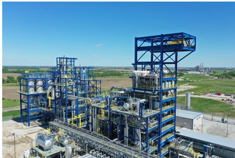
Abb. 32: Im Aufbau befindliche Methanpyrolyseanlage der Firma Monolith Materials in Olive Creek, Nebraska (USA) 48
