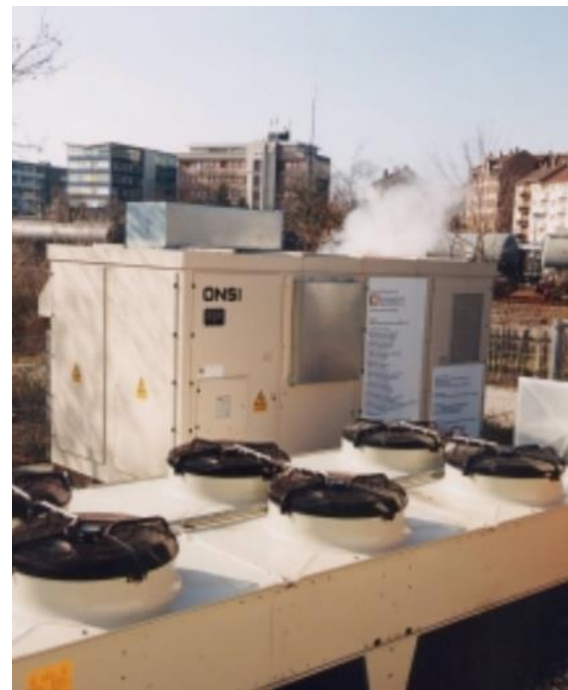
Abb. 63: 200 kW Onsi-PAFC Brennstoffzelle (PC25C) der EWAG AG in Nürnberg, 1998
