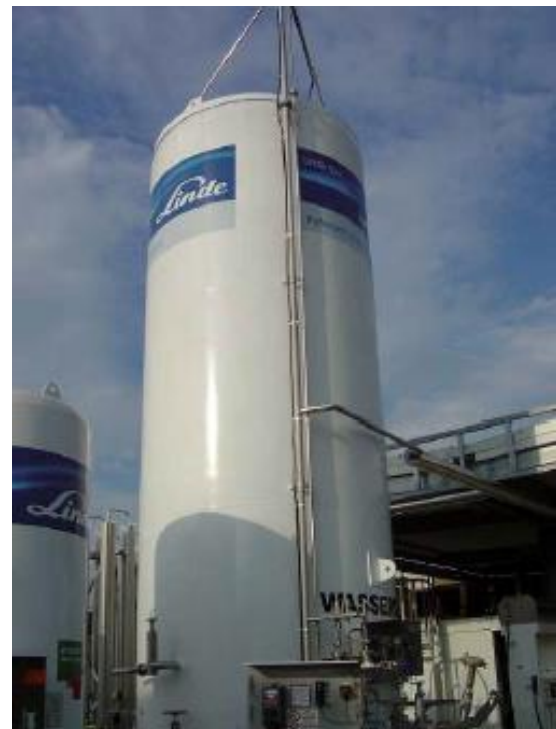
Abb. 39: Wasserstoffkryospeicher der Firma Linde
