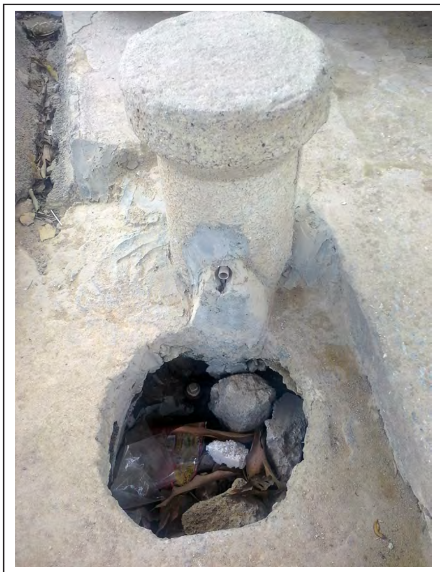
Foto No 4: Mina do Ponto de Ônibus seca, Jardim da Fonte (outubro de 2014)
