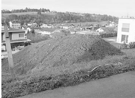
Zwischenlager für Oberbodenaushub an einer Baustelle (Ebikon LU). In solchen Bodenlagerungen kann der CO 2 -Gehalt sehr hoch werden. Photo: A.Schönborn
