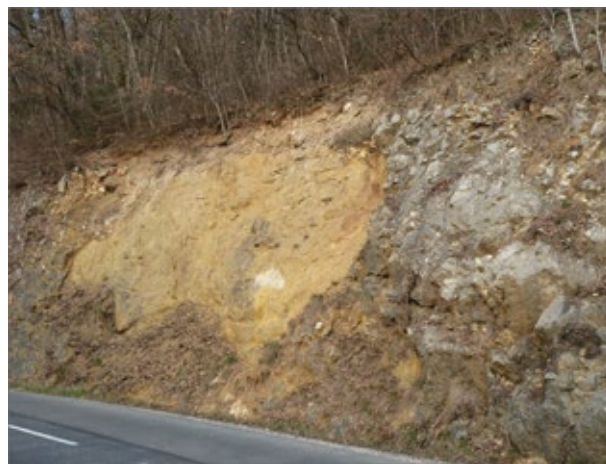
Fig. 41 : Remplissage de cavités karstiques dans l'Urgonien blanc auct. par des grès sidérolithiques à hydroxydes de fer; talus de la D41A entre Mornex et Monnetier (Petit Salève).
