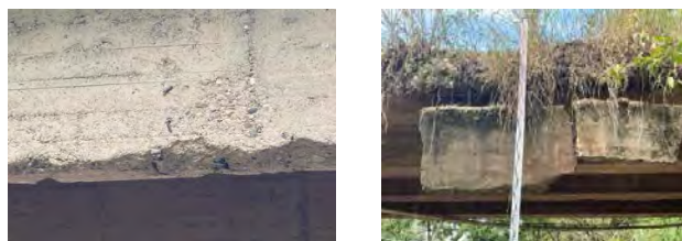
Figura 5. Viga de un puente con deterioro del concreto por abrasión, ocasionando la exposición del acero de refuerzo (izq) y colapso de una viga por impacto de material transportado por el río
