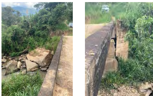
Figura 7. Colapso de estribos y obras de protección ante socavación
