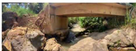
Figura 6. Socavación de un estribo y fundación de un puente, cimentado sobre material aluvial
