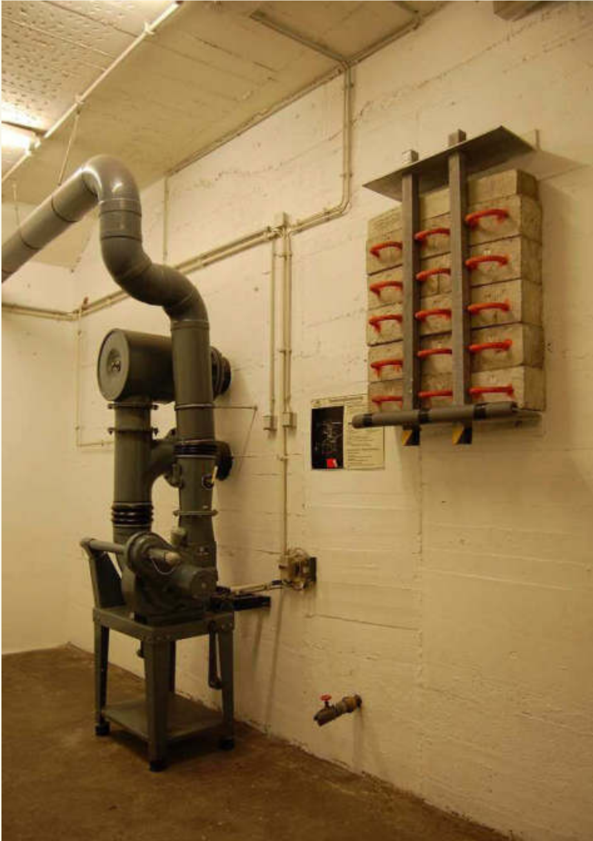
Berlin, reaktivierte Zivilschutzanlage, Blochplatz, Belüftungstechnik (Bild: Holger Happel)
