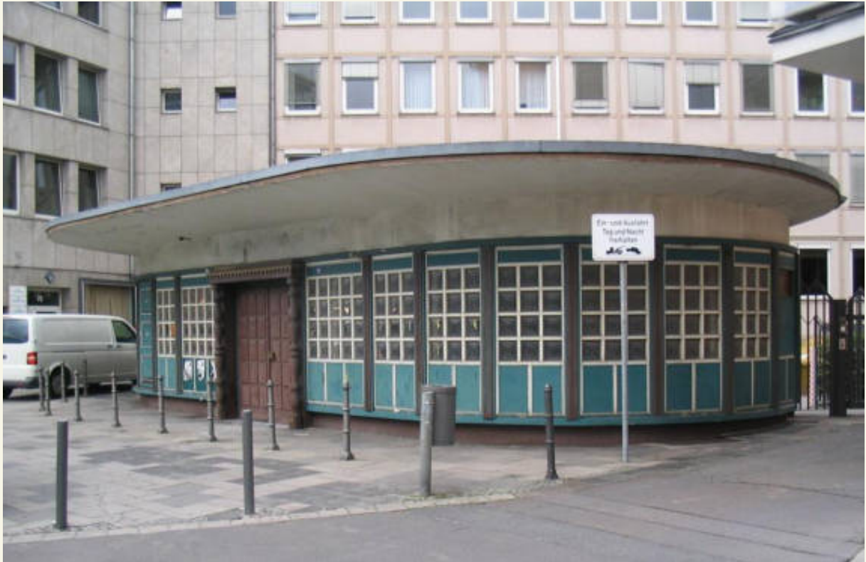
Frankfurt am Main, Café „Heimat“ vor der Sanierung (Bild: Christian Schmidt, Offenbach am Main)
