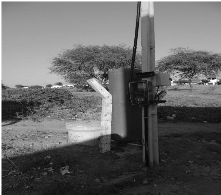
Figura 5 - Poço instalado no cristalino com sistema de pressurização. Crédito: SAAE Quixeramobim.
