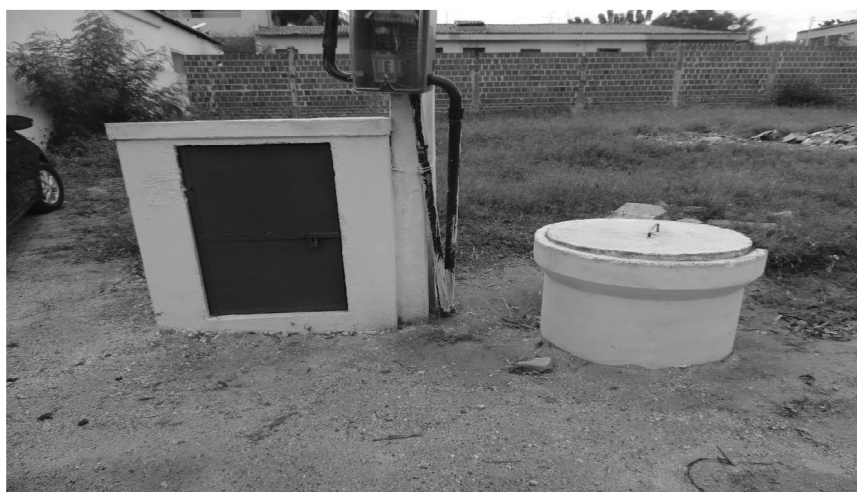
Figura 6 - Poço instalado no cristalino com sistema de pressurização. Crédito: SAAE Quixeramobim.
