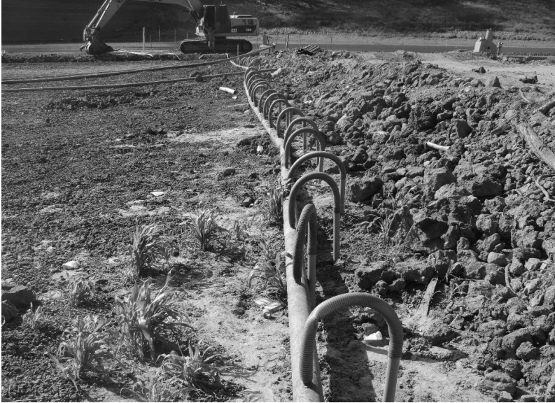
Figura 3: Sistema de Ponteiros realizados no Açude Quixeramobim. Crédito: SAAE Quixeramobim.
