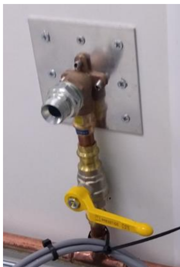
Figuur 11 Gasafsluiter met opening voor uitstroom
