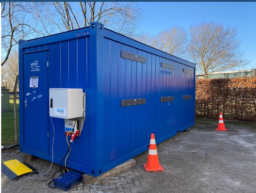
Figuur 12 Foto van zijkant van de container met de 6 ventilatieopeningen
