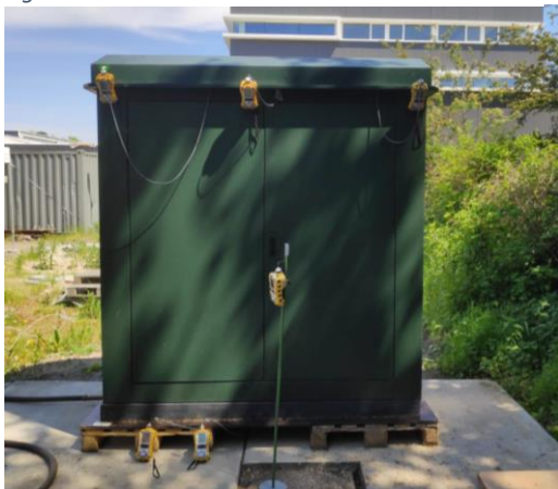
Figuur 26. Het 4m3 kaststation in een buitensituatie
