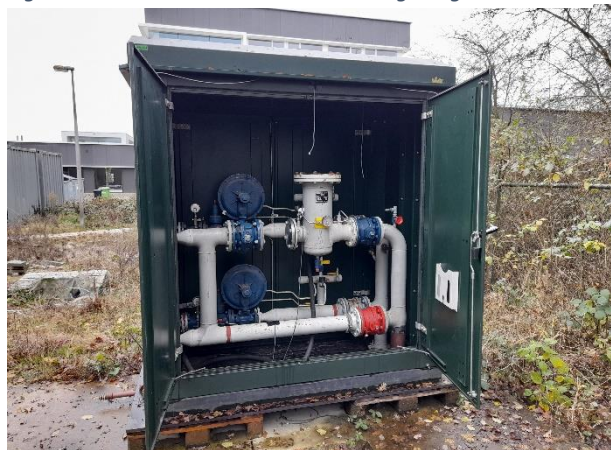
Figuur 27. Het 4m3 kaststation met daarin het gasregelstation
