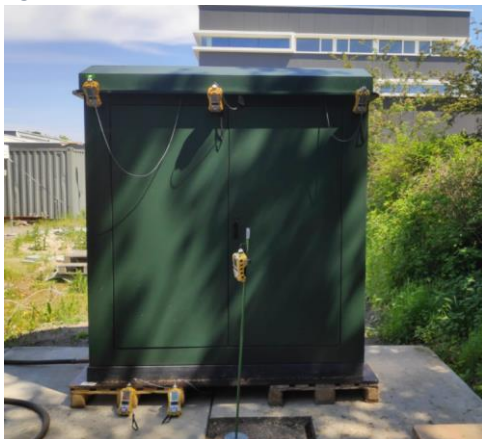
Figuur 7. Het 4m 3 kaststation in een buitensituatie
