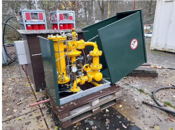
Figuur 25. De ½ m3 kast met daarin het gasregelstation
