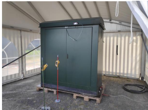
Figuur 8. Het 4m 3 kaststation in een tent
