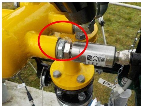
Figuur 7: Lekkage bij aansluiting druksensor P2
