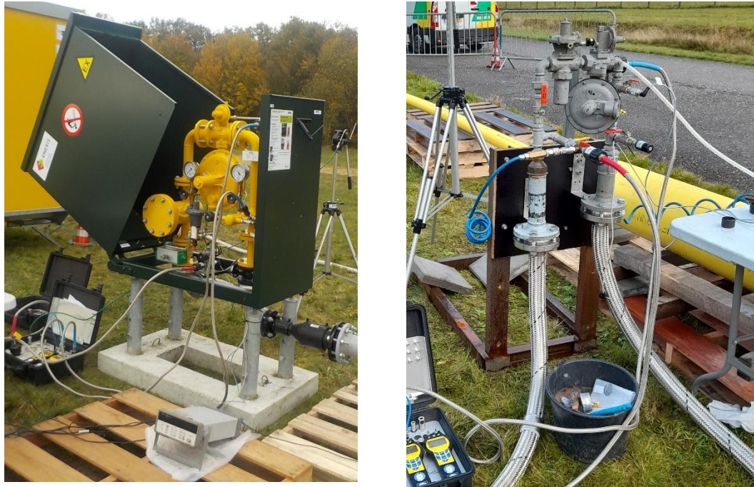
Figuur 1: Gasdrukregelstation (districtstation) links en Hogedrukafleverstation (HAS) rechts
