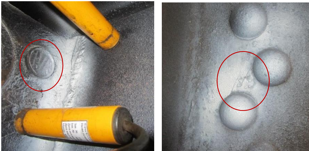
Рисунок 7.9 – Дефекти несучих металоконструкцій вантажних вагонів виявлені за допомогою МТ методу
