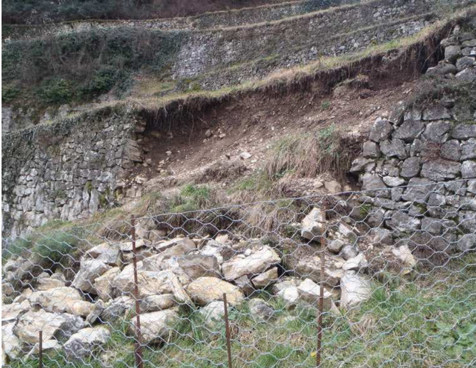
Fig.1 Muro crollato in località Oliero, Comune di Valstagna
