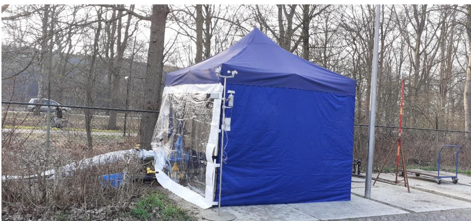
De toegepaste afscherming om de geopende afsluiter.
