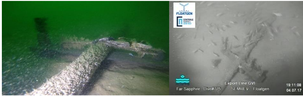
FIGURE 44 : PHOTOGRAPHIES D'ÉQUERRES DE STABILISATION DES CABLES ÉLECTRIQUES. BW IDEOL & CN – SEM-REV)
