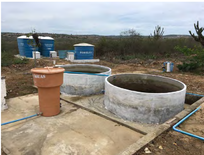
Figura 13 - Reator UASB utilizado no experimento Fonte: Arquivo de propriedade do INSA (Foto: Mateus Mayer).
