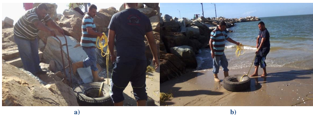
Figura 2. a) y b) Traslado de la estructura de concreto o muerto a la zona de cultivo.
