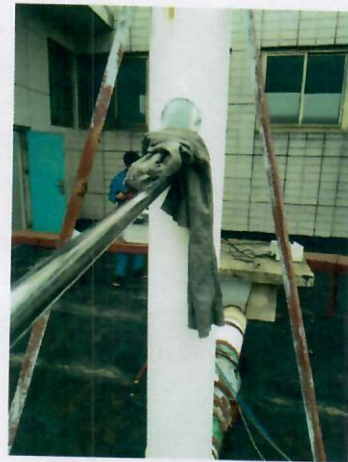
生物安全柜排气筒 6#
