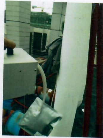
普通实验室排气筒 4#
