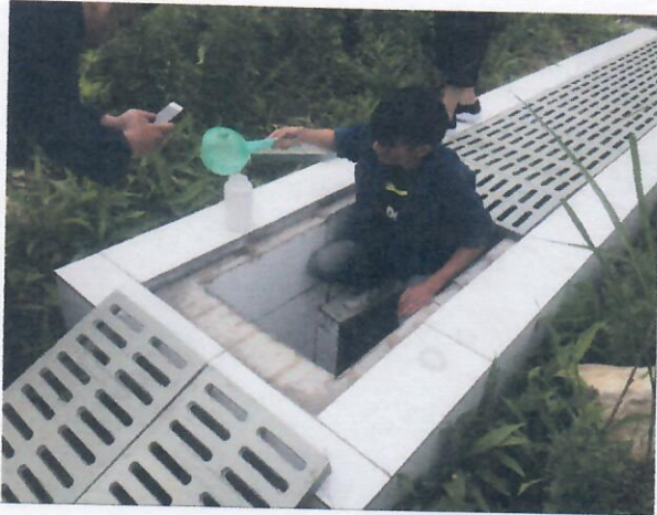
污水处理设施进口
