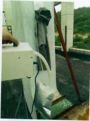
P2 实验室通风排气筒 3#
