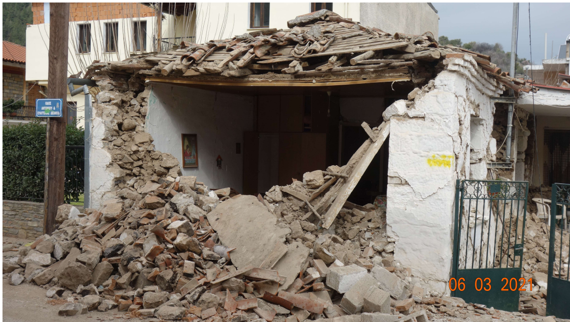
Εικόνα ΣΤΑ4 . Εκτός επιπέδου αστοχίες λιθοδομών σε διώροφο και μονώροφο κτήριο στο Δαμάσι.
