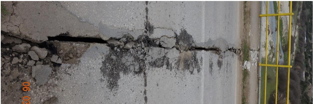
Εικόνα ΣΤΑ15 . Τοπικές αστοχίες στον αρμό της γέφυρας στην είσοδο του Δαμασίου. Εμφανίστηκαν και στους δύο αρμούς στα άκρα της γέφυρας.
