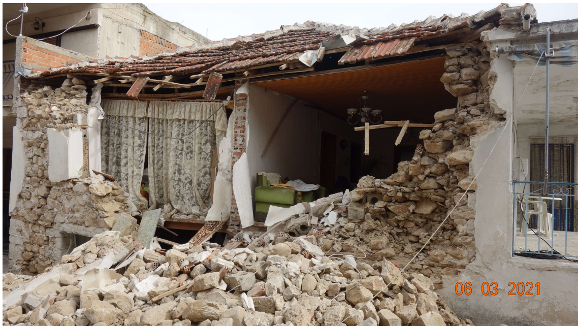
Εικόνα ΣΤΑ3. Εκτός επιπέδου αστοχία λιθοδομών σε μονώροφα κτήρια στο Δαμάσι
