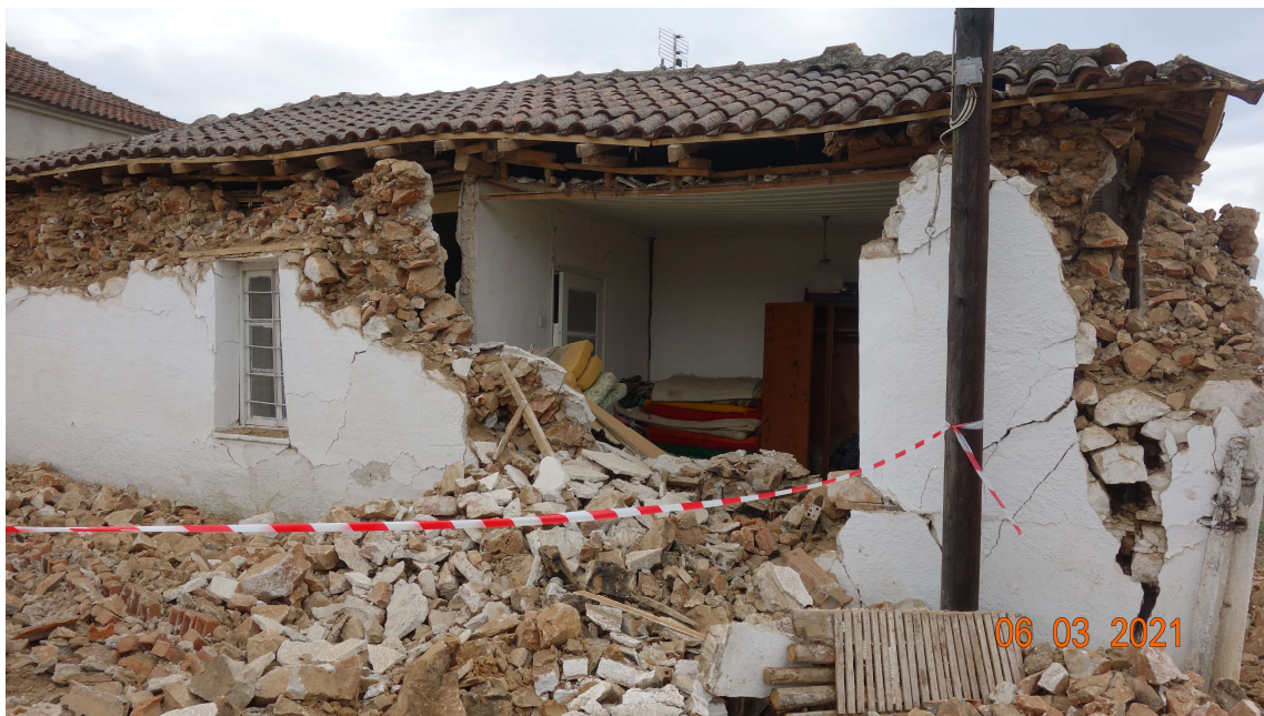
Εικόνα ΣΤΑ6. Εκτός επιπέδου αστοχίες λιθοδομών σε δώροφο και μονώροφο κτήριο, από φέρουσα λιθοδομή, στο Μεσοχώρι
