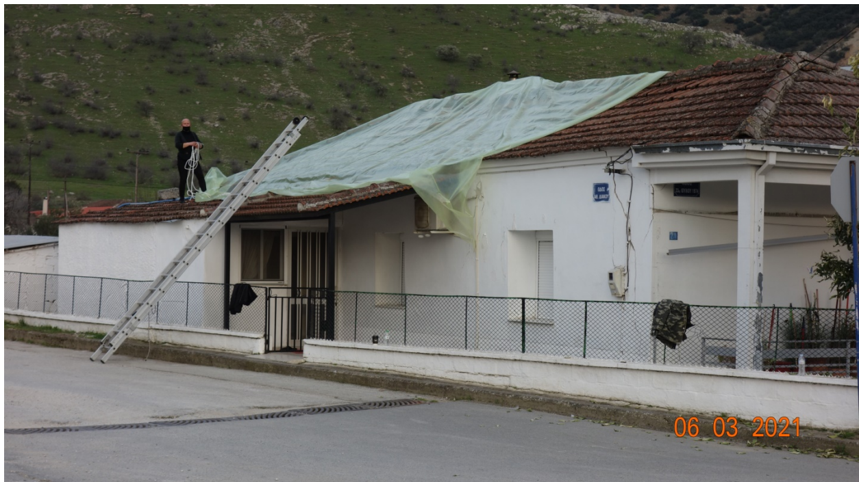
Εικόνα ΣΤΑ14. Κάλυψη κτηρίων με νάilon για την προστασία της περιεχόμενης οικοσκευής από νερά της βροχής. Υπάρχουν θραύσεις και μετακινήσεις κεραμιδιών λόγω του σεισμού.
