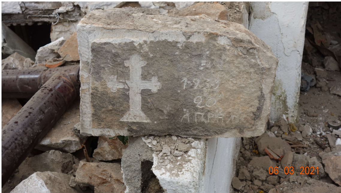
Εικόνα ΣΤΑ5. Αστοχία λιθοδομών στο άνω μέρος τους σε κτήριο κατασκευής του 1933.
