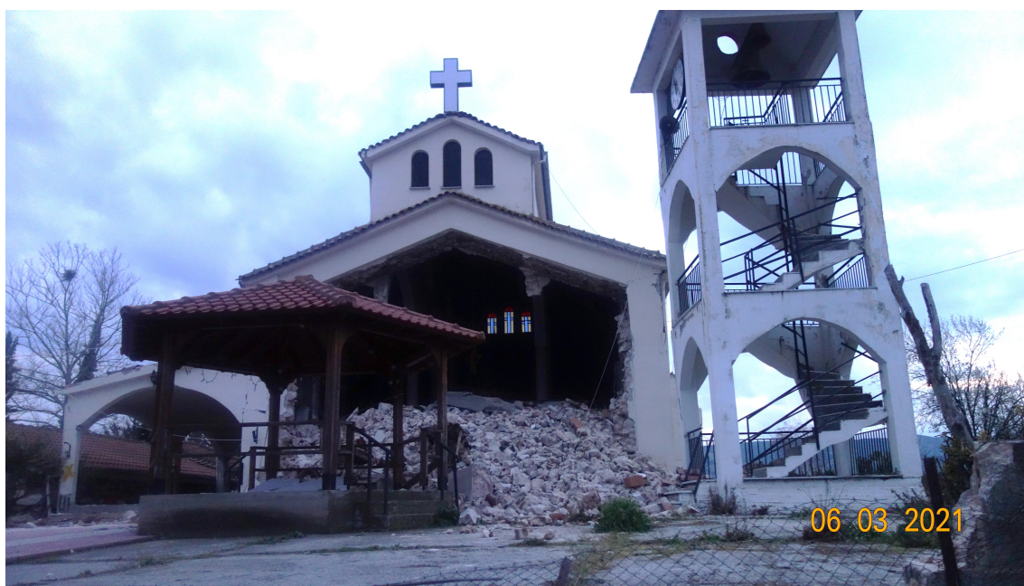
Εικόνα ΣΤΑ10. Άνω: Τοπικές Αστοχίες στην στέψη λιθοδομών σε Ναό στο Μεσοχώρι. Αστοχία σε τοιχοπλήρωση κοιμητηριακού Ναού στο Κουτσόγερο.
