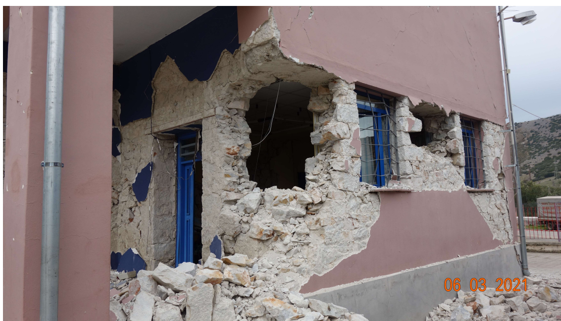
Εικόνα ΣΤΑ9. Δημοτικό σχολείο στο Δαμάσι. Ρηγματώσεις κατανεμημένες σε πολλά φέροντα στοιχεία και τοπικές καταρρεύσεις.
