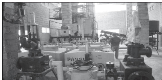
Figura 6. Interior de la nave con el equipamiento tecnológico.
