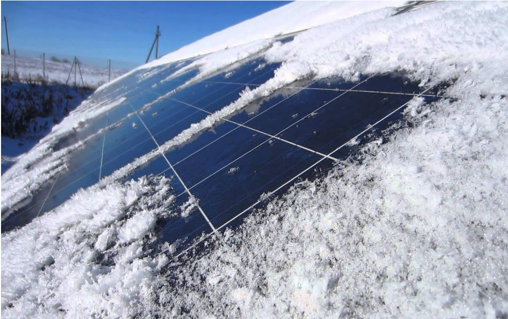
Şəkil 2. Günəş panellərinin görünüşü
