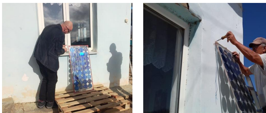
Рис. 1. Вариант монтажа солнечного модуля: 1 - наземный, 2 - стена здания. Фото Битяевой Г.Е.
