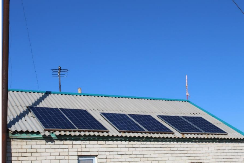
Рис. 2. Вариант монтажа солнечного модуля на крыше здания на кордоне заповедника Черные Земли. Фото Сангаджиева М.М.
