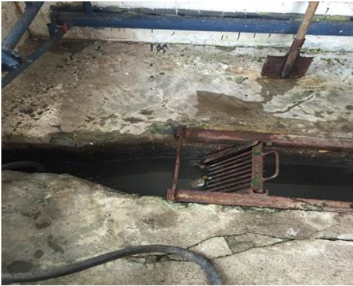
i. WWTP screen
