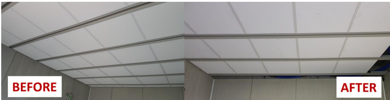
Slika 65: Predhodno vgrajen spuščeni strop (levo), zamenjan s sevalnimi stropni ploščami InnoWEE (desno)
