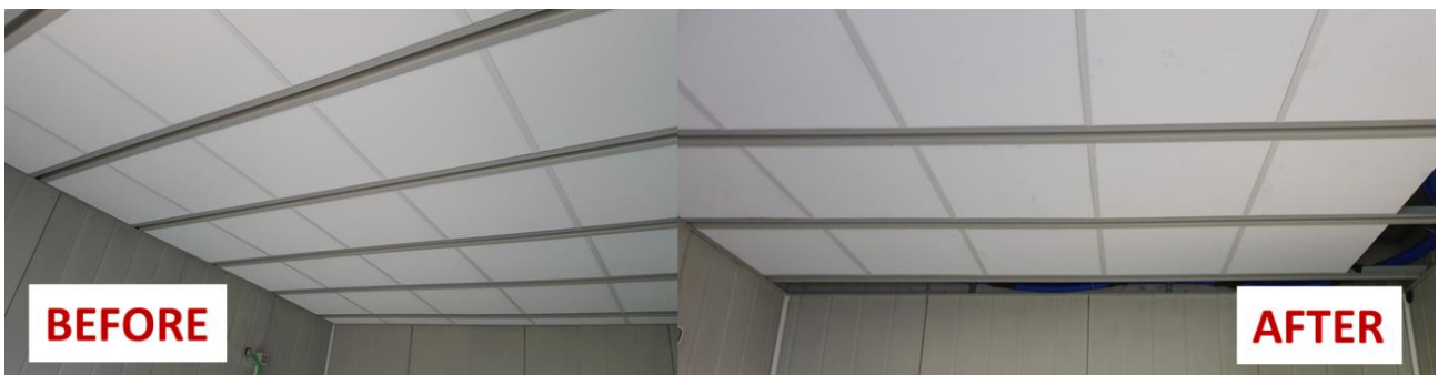
Ryc. 65. Wcześniej zamontowany sufit podwieszany (po lewej), zastąpiony przez panele promieniujące InnoWEE (po prawej)
