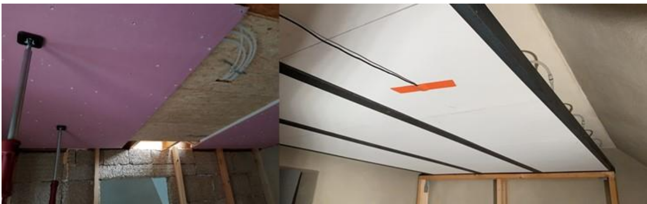
Ryc. 79. Panele komercyjne (po lewej) i promienniki InnoWEE (po prawej) zainstalowane w suficie
