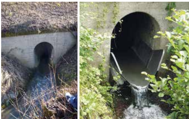
Abb. 9: Verkleidung des Rohrdurchlasses im Finsterbach mit halbschalenförmigen Edelstahlblech vorher (links) und nachher (rechts)
