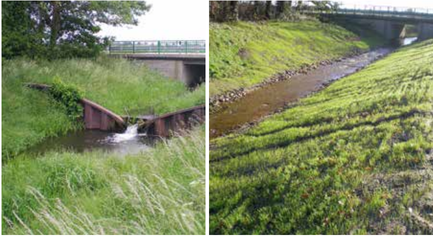
Abb. 1: Sohlabsturz in der Lotter Beeke im Landkreis Emsland vor (links) und nach Schaffung der Durchgängigkeit durch Herstellung einer Sohlgleite (rechts)
