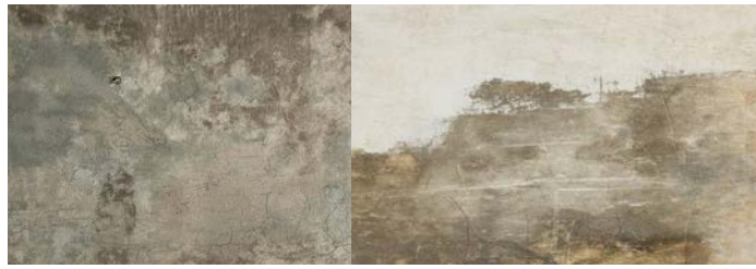
Figura 16. Eflorescencias en muro y placa
