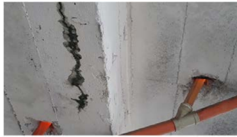
Figura 9. Conexiones mal hechas y filtraciones
