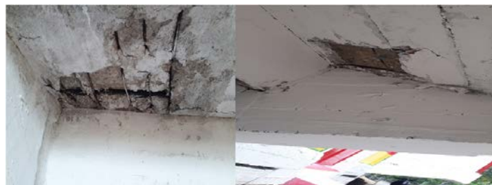
Figura 11. Desprendimientos, exposición de aceros
