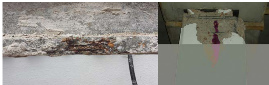
Figura 15. Carbontacaión en viga y columna
