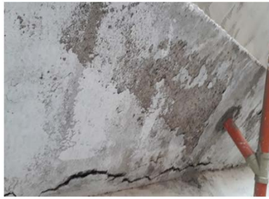
Figura 4. Lesiones comunes de la estructura
