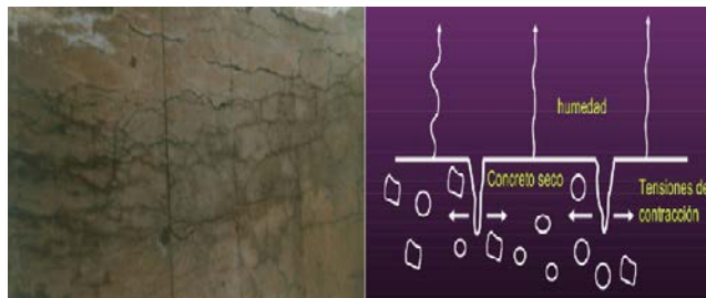
Figura 17. Delaminación en el concreto
