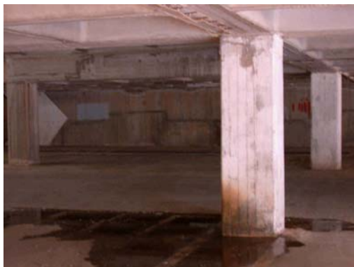
Εικόνα 3.22: Αρμός διαστολής στην οροφή των Πλατειών Κέντρου στην Πολυτεχνειούπολη Ζωγράφου
