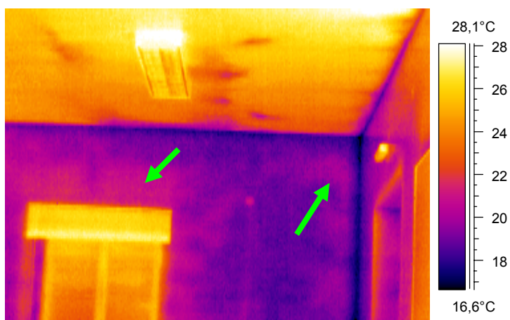
Εικόνα 3.17 Θερμογράφημα τοίχου στο «Φαρμακείο» ( ΤΠΠΑ ). Στο θερμογράφημα σημειώνονται οι θερμές περιοχές της τοιχοποιίας δίπλα στο κούφωμα του παραθύρου οι οποίες είναι από οπτοπλινθοδομή σε αντίθεση με τις ψυχρές περιοχές οι οποίες είναι δομημένες με φυσικούς λίθους.
