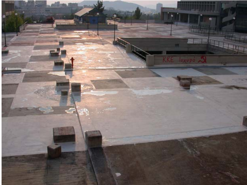
Εικόνα 4.10: Εικόνα των πλατειών τέσσερις ώρες μετά την βροχή
