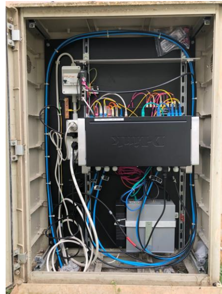
Figure 22: Street Cabinet in Via della Cavallerizza – Lucca. Edge Server (bottom) and L2 Switch (top).
