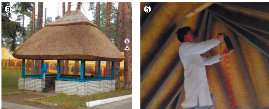
Рис. 9.47. Виконання робіт по вогнезахисту внутрішніх несучих дерев'яних конструкцій шатрового даху альтанки: а – зовнішній та внутрішній вигляд альтанки; б – пневморозпорошення покриття на діагональні скісні крокви, наріжники та розпірки
