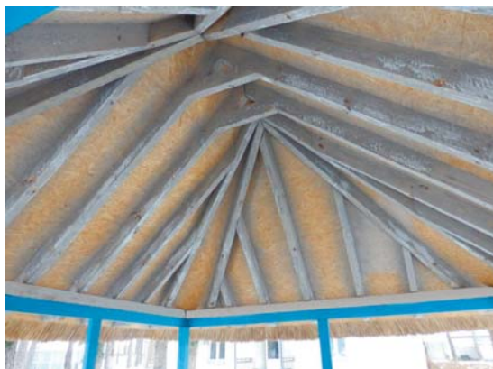
Рис. 9.50 Зовнішній вигляд вогнезахисних внутрішніх поверхонь основних несучих дерев'яних конструкцій шатрового даху альтанки після року експлуатації в перемінних атмосферних умовах
