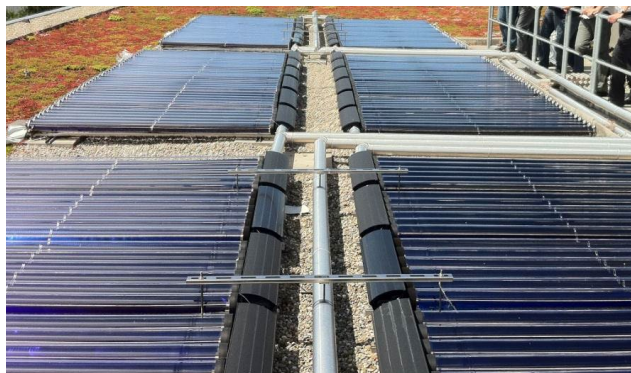
Abb. 1: Thermische Solaranlage flach auf dem Dach montiert
