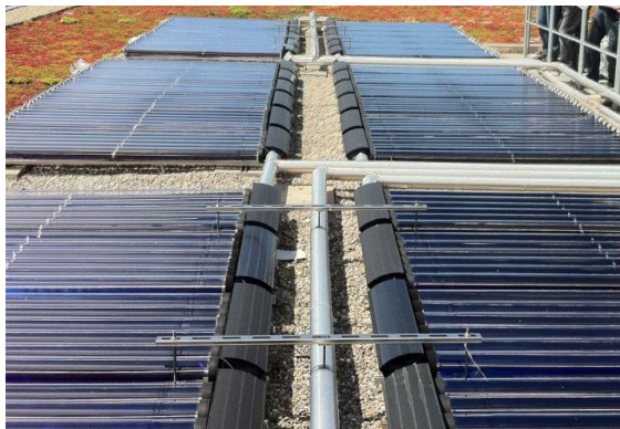
Abb. 1: Thermische Solaranlage flach auf dem Dach montiert
