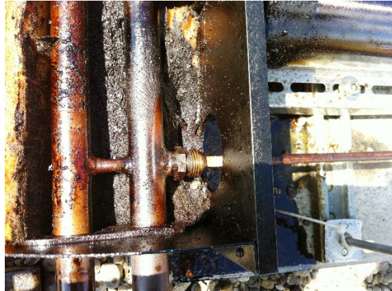
Abb. 3: Verschmutzung und zähflüssige Schicht im Innenrohr
