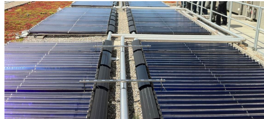
Abb. 1: Thermische Solaranlage flach auf dem Dach montiert
