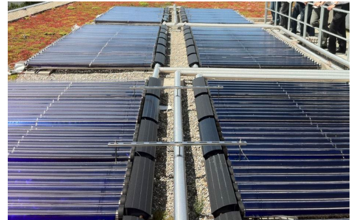
Abb. 1: Thermische Solaranlage flach auf dem Dach montiert
