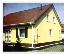
Bild 4: Vertikalfisse aus vertikalen Leertagen mit Vertikalfisse in Erdgeschoss und horizontalen in den Lagertagen (links: Mauerwerk rechts: Doppelmauerwerk).
