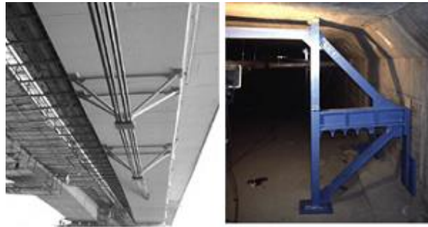
Figura 3. Postensado correctivo externo e interno aplicado en puentes viga cajón con problemas de deflexión excesiva [33], [34]
