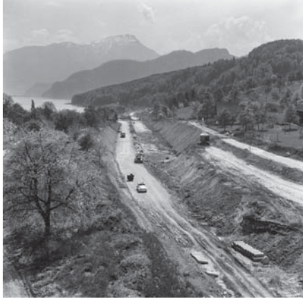
Abb. 13: Die Baustelle frisst sich in die Landschaft. Bildnachweis: Keystone / Photopress-Archiv / Jules Vogt.
