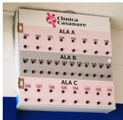
Figura 3. Tablero de timbres hospitalización
