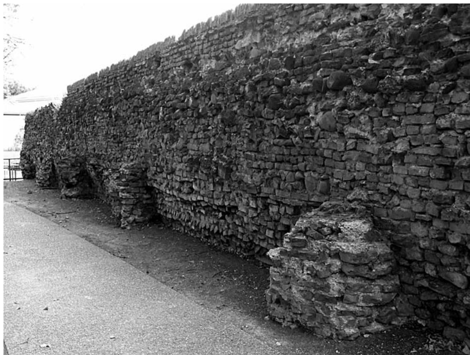
Fig. 6. Tratto di cinta muraria del XVI secolo in via Bastioni Meridionali (Foto N. Leoni). Si noti la presenza dei setti murari di sostegno ortogonali al paramento interno delle mura
