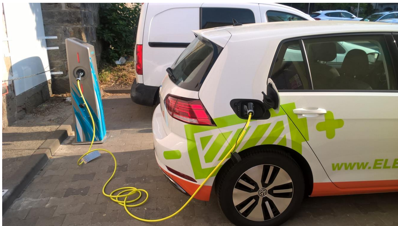
obrázek 7 Dobíjecí stanice Siemens umístěná v lokalitě Děčín (2xkonektory Mennekes 3x32A/400V)
