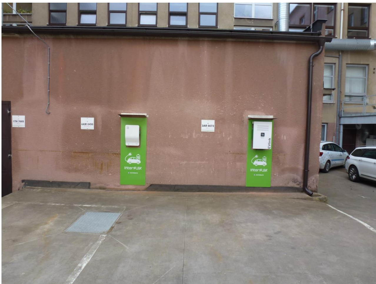
obrázek 8 Dobíjecí stanice Schneider Electric umístěné v lokalitě Hradec Králové (každá stanice má 1x konektor Mennekes 3x32A/400V + domácí zásuvku 1x16A/230V)
